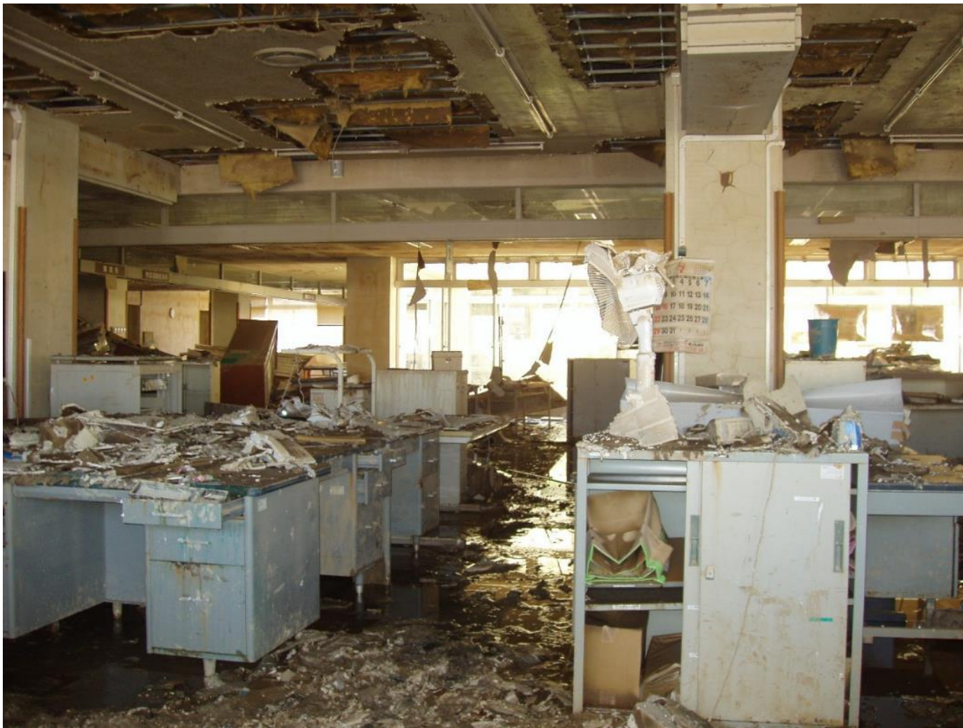
7月24日 倉敷市真備支所1階
